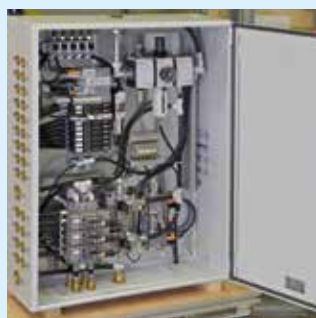
Электропневматический шкаф управления для управления всем автоматизированным процессом
