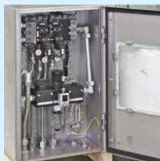
Шкаф управления с прозрачным окном и металлическими трубками
